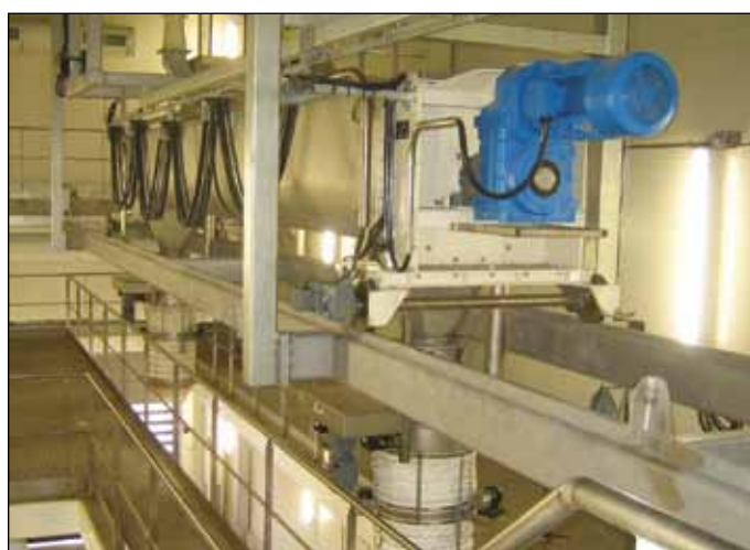
Рис. 7. Шнековые транспортеры с телескопическими погрузочными устройствами для бестарной погрузки сахара
